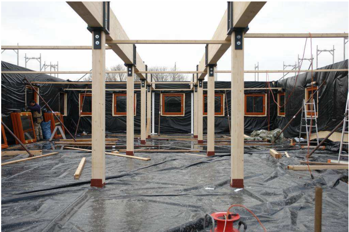
Am Nachmittag steht die Decken-Tragkonstruktion eine Haushälfte und am nächsten Vormittag wird die Decke fertig montiert. Damit ist ein komplettes Geschoß witterungsfest.
